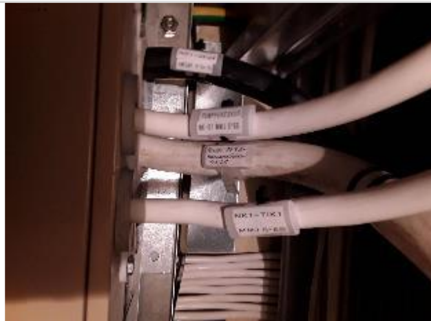
Pääsääntöisesti nousukeskusten kaapeloinnit ovat tehty viisijohdinjärjestelmään
