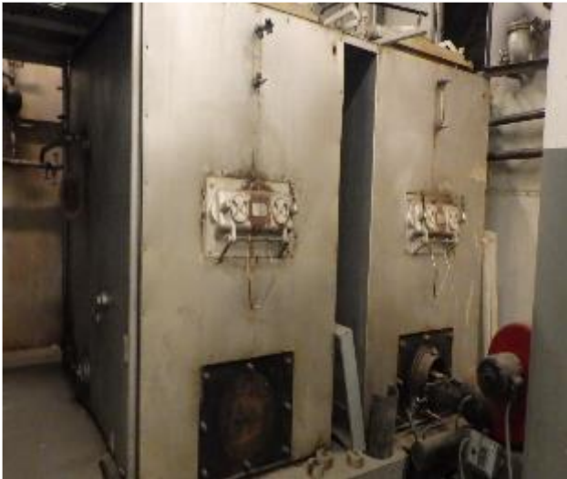
Yleiskuva kahdesta vanhasta lämmityskattilasta
