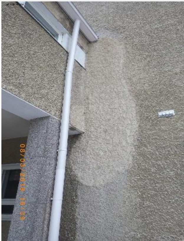
Julkisivussa näkyy katolta tulleen kosteuden valumajälkiä
