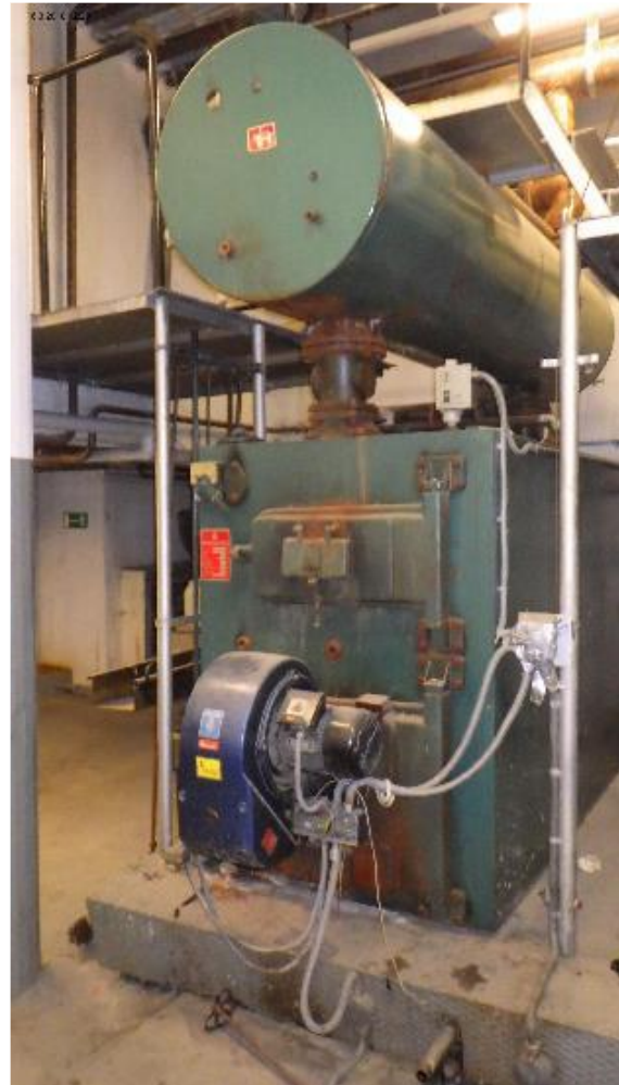
Yleiskuva yhdestä vanhasta lämmityskattilasta
