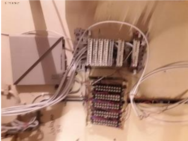
Nousukeskushuoneen vanha puhelinjakamo on liitetty päätelejakamoon
