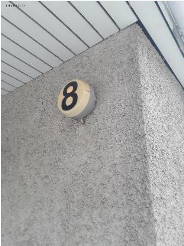
Numerovalaisimen muovikupu on kellastunut
