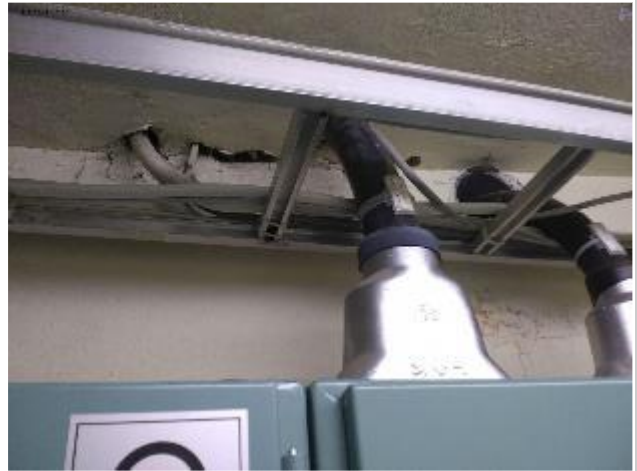
Palokatkot ovat puutteellisia ja niitä tulee korjata
