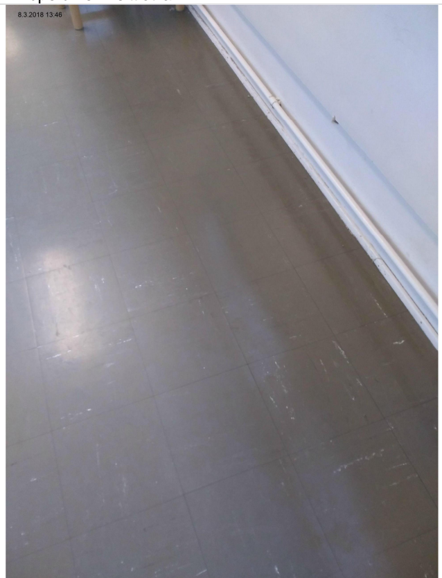
Yleisissä tiloissa lattian vinyylilaattapinnoite, joka saattaa sisältää asbestia
