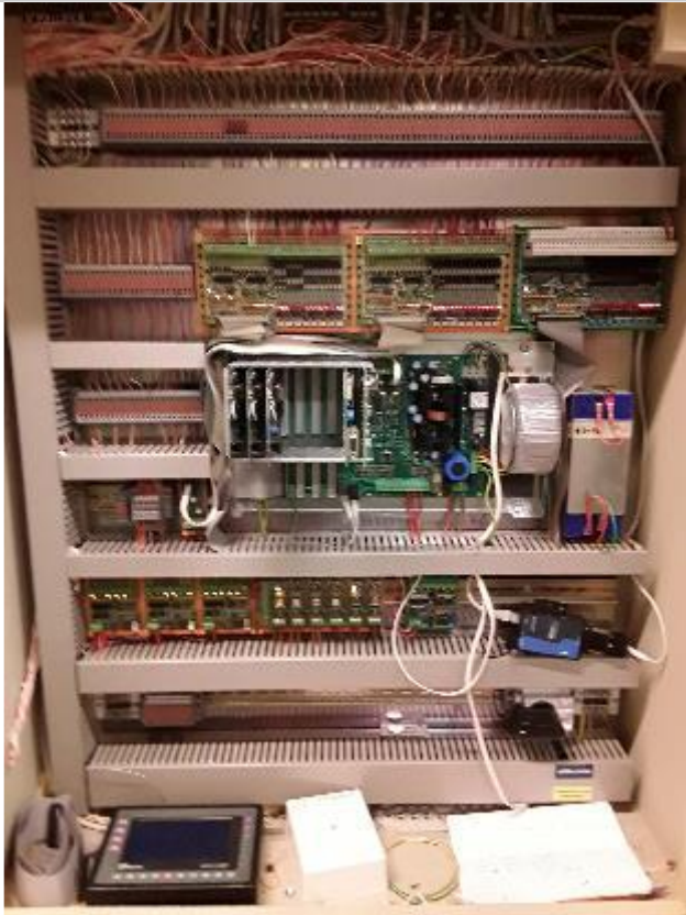
Lämmönjakuhuoneeseen on sijoitettu kiinteistöautomaation valvonta-alakeskus
