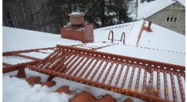
Vesikaton turvavarusteet ovat puutteelliset. Katolle suositellaan kuntotarkastusta.
