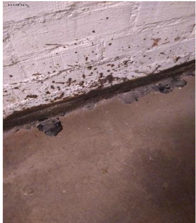
Kellaritiloissa näkyy pikieristeitä. Saattaa sisältää haitta-aineita
