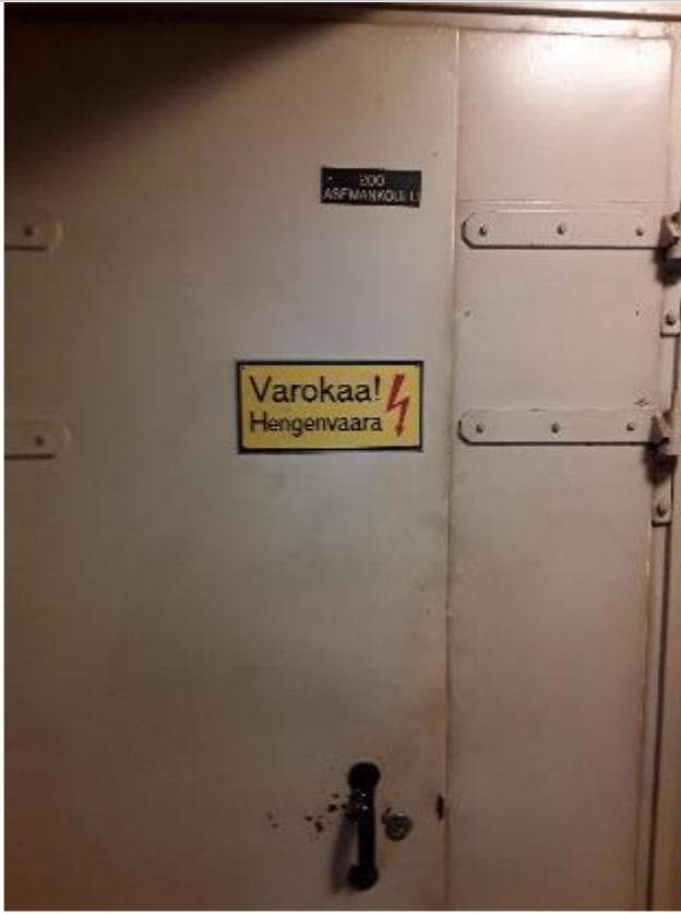
Kiinteistön kellarikerroksessa on Caruna Oy:n muuntamo
