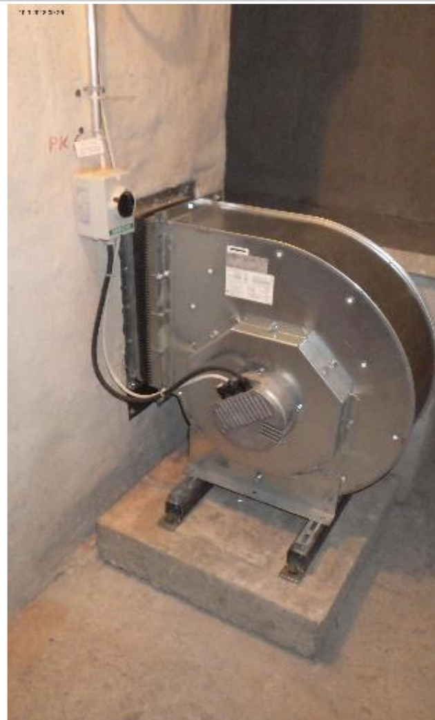
Yleiskuva rakenneaineeseen hormiin liitetyistä poistoilmavaihtokoneista.
