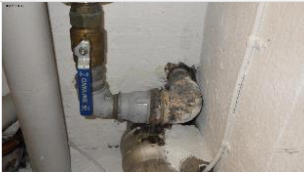
Kylmänkäyttöveden nousujohtot on tehty sinkitystä teräsputkesta.
