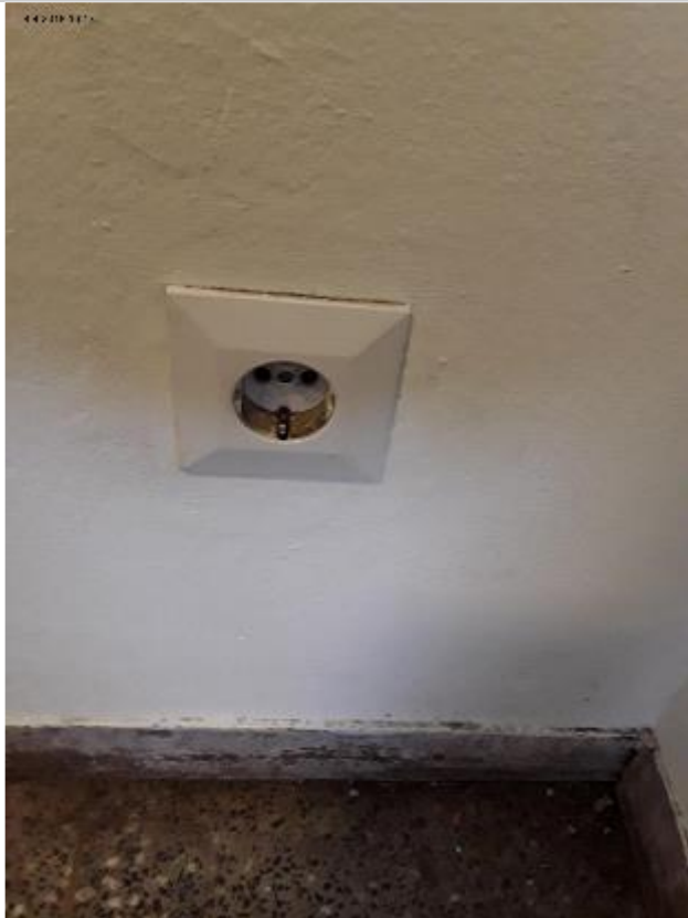
Pistorasiat ovat suojakoskettimella varustettuja pistorasioita, eikä tarkastuskierroksella havaittu nolaluokan pistorasioita
