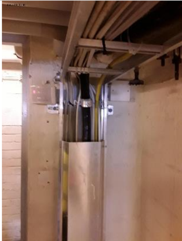
Kellaritiloissa on asennettu tikashyllyjä kaapelireiteille
