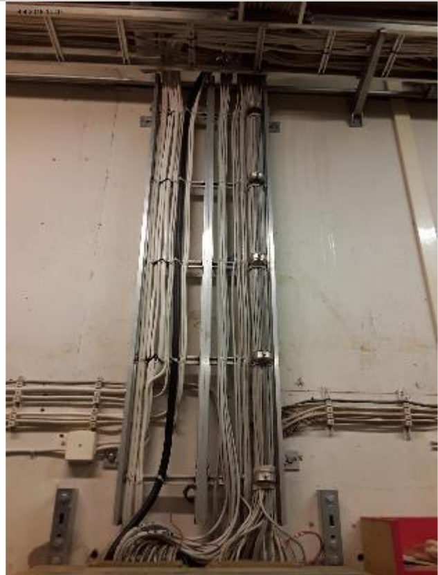
Kaapeleille on käytetty riittävästi kiinnikkeitä ja hyllyillä on tilaa vielä lisäkaapeloinneille
