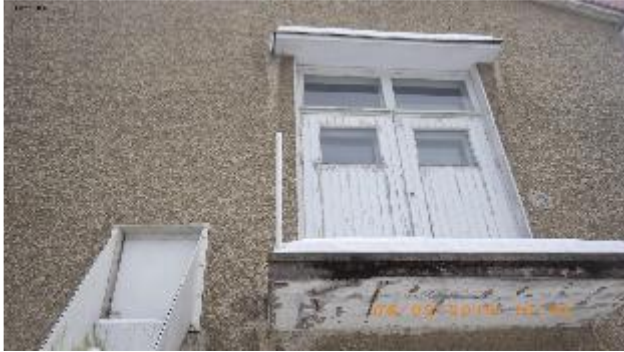
Kuvaa parvekkeesta. Alapinnassa teräkset näkyvillä. Pinnoitevaurioita.
