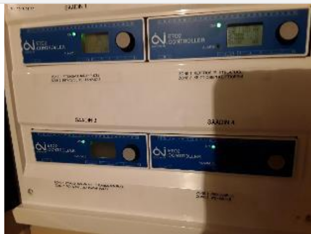
Neljä säädintä ohjaa räystääs- ja syöksytorvilämmityksiä
