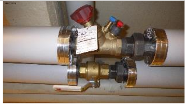
Yleiskuva lämpöjohtoverkoston sulku- ja linjasäätöventtiileistä
