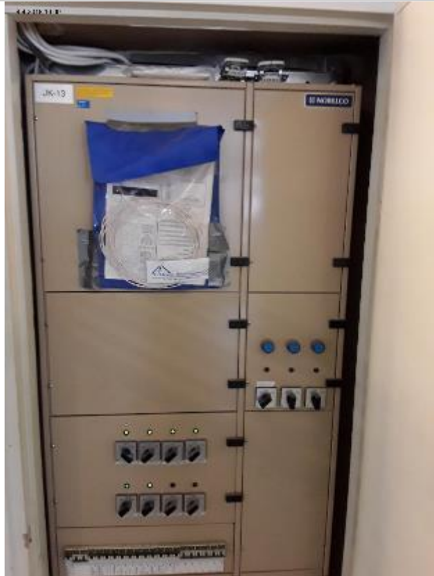
JK 1.3, kerroskohtaiset jakokeskukset ovat sijoitettu erillisiin komeroihin, joissa ovat myös nousuhyllyt keskusten syötöille
