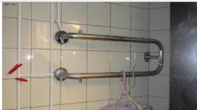
Yleiskuva koulun kiertovesipatterista
