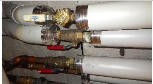
Yleiskuva käyttövesiverkon sulku- ja linjasäätöventtiileistä.
