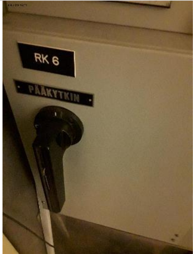
RK 6, keittiön keskus on jätetty uusimatta vuonna 2000 saneerauksessa
