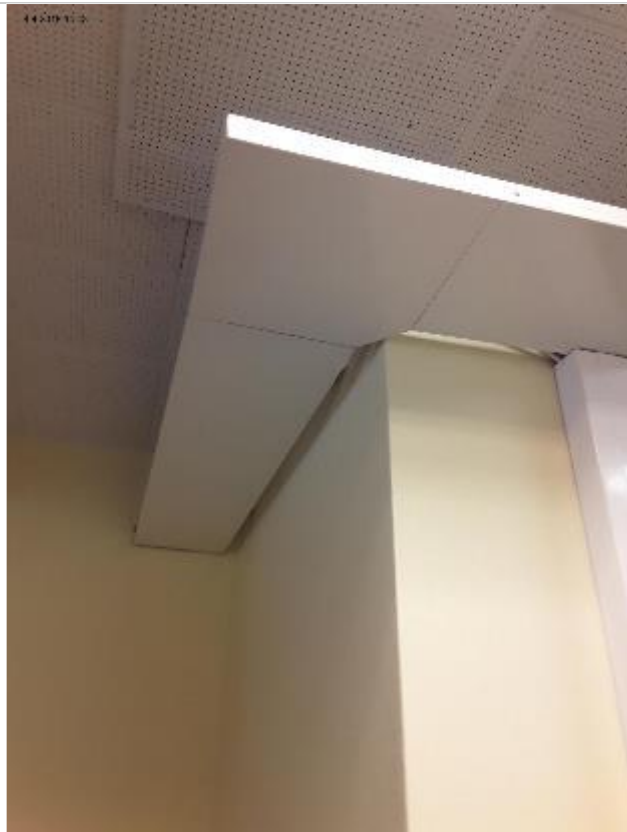
Levyhylyjä on käytetty koulurakennuksen käytävillä ja luokkatilojen sähköistämiseen
