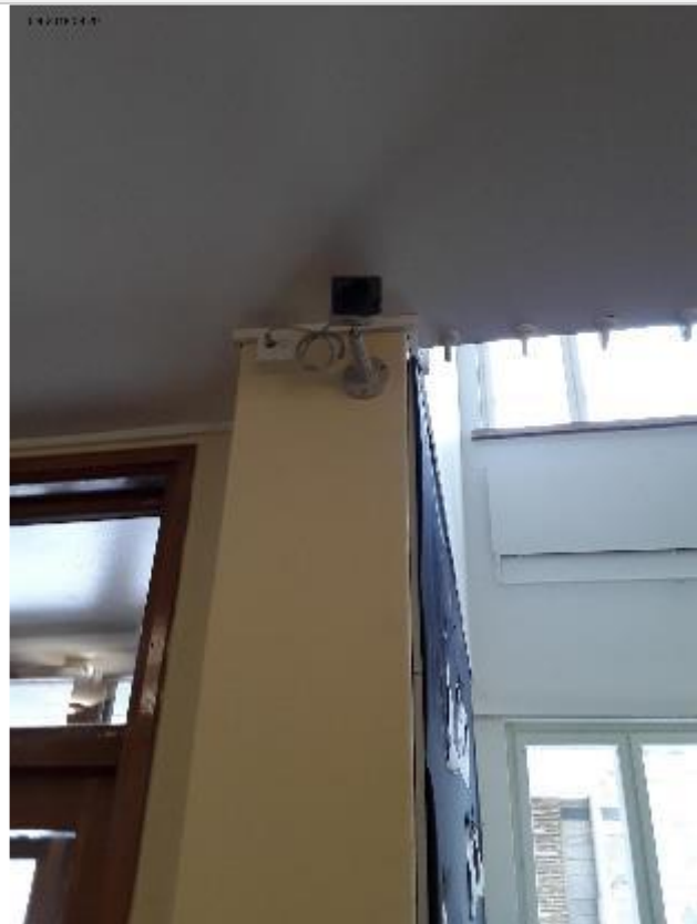
Kamerat ovat yleiskaapelointiverkkoon kytkettyjä kameroita
