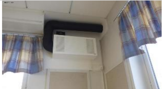
Koulun luokkia on osittain varustettu Mobair tuloilmalaitteilla.
