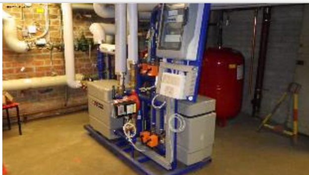
Yleiskuva kaukolämmön alajakokeskuksesta.
