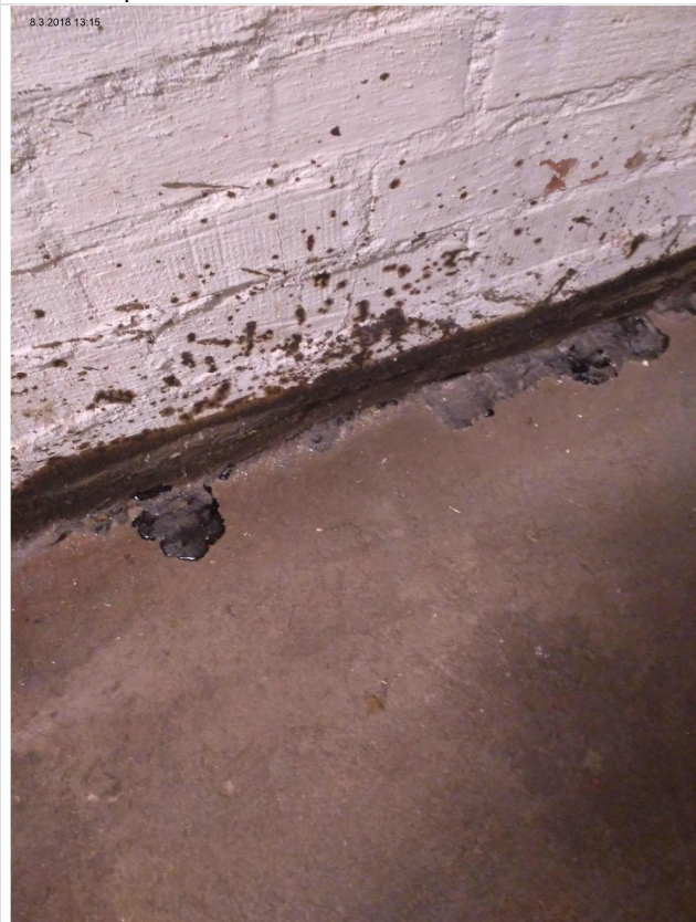
Kellaritiloissa näkyy pikieristeitä. saattaa sisältää haitta-aineita
