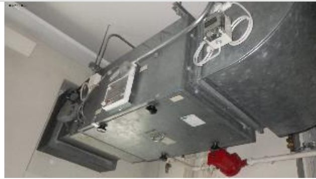
Yleiskuva ATK- ja kerhotiloja palvelevasta tuloilmakoneesta
