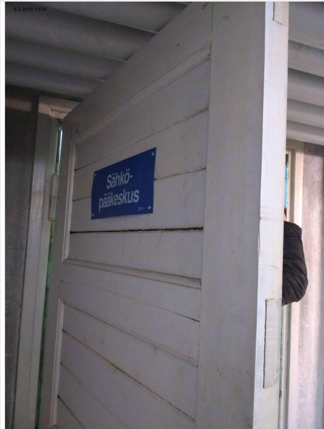
Kellari yleistyypinen puuovi. sähköpääkeskuksessa uusittava palo-oveksi
