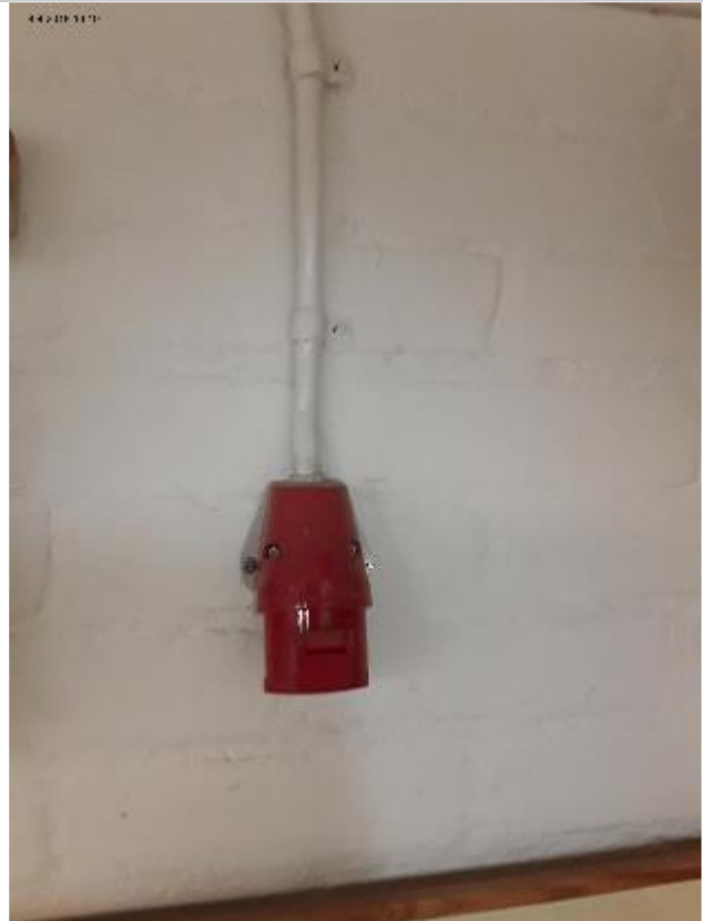
Voimapistorasioita havaittiin kellarissa ja keittiössä
