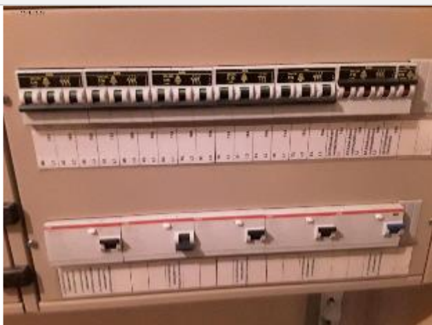
Nousukeskuksessa on kolme kahvavarokelähtöä laajennuksille ja kiinteistöosuudessa on useampi varuslakelähtö ryhmätason lähdöille
