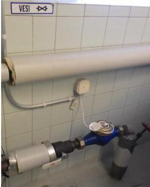
Kiinteistön päävesimittari ja sulut sijaitsevat koulun ruokalan keittiön takatilassa
