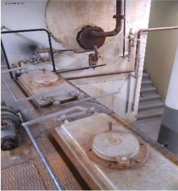
Suojakaiteet ovat puutteellisia
