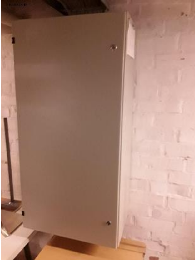
Päätelejakamo on kellarikäytävällä
