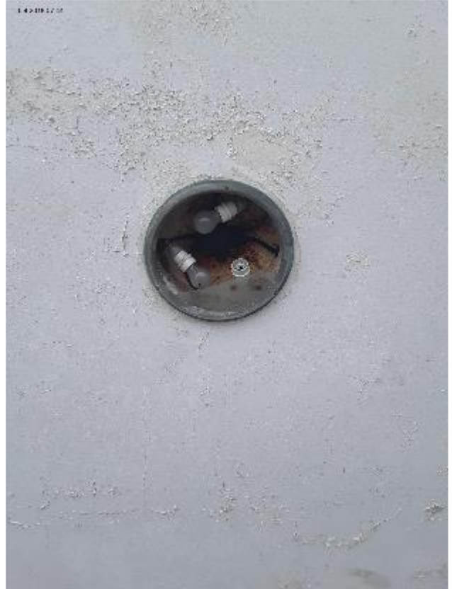
Valaisimissa on ruosteaurioita ja lamppujen suojalasi on rikkoutunut
