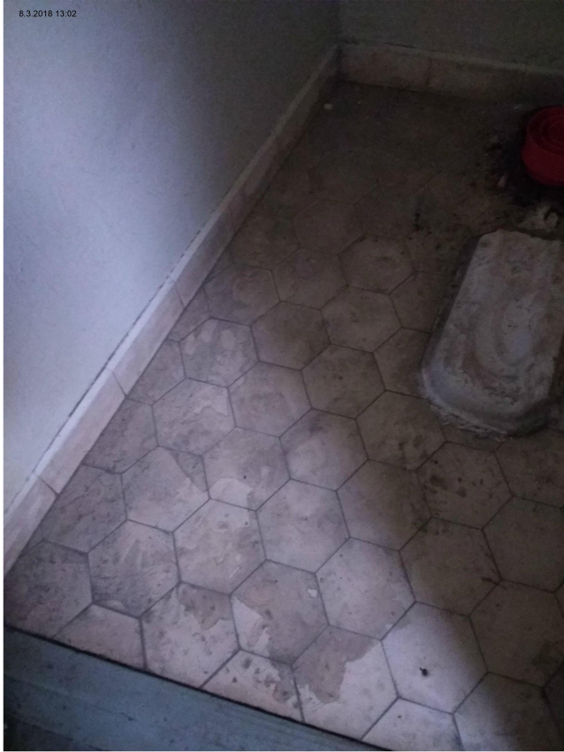
Vanha laatoitus ja kiinnityslaasti saattaa sisältää asbestia
