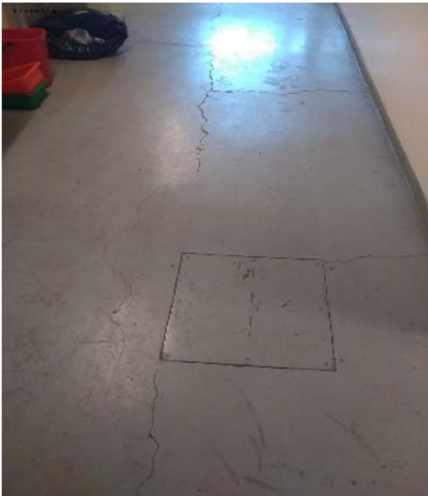
Kellarin tiloissa alapohjarakenteessa on halkeamia. Alapohja on betonirakenteinen
