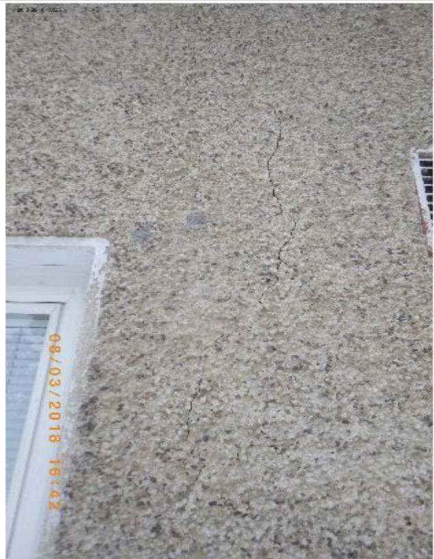
Julkisivun rappauksessa esiintyy halkeilua
