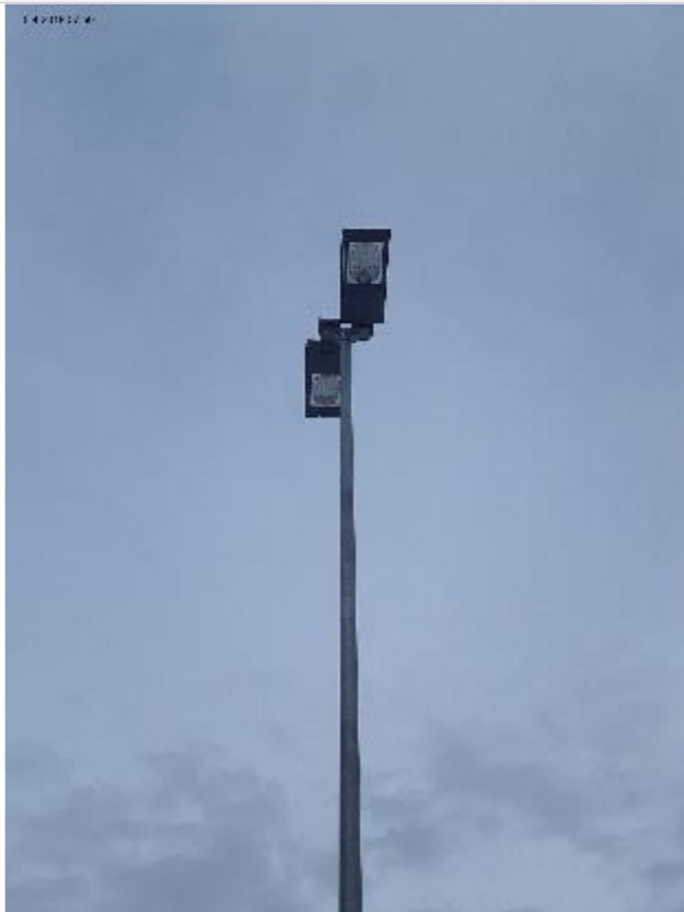
Pylväsvalaisinten lamput vaikuttavat olevan monimetallivalaisimia
