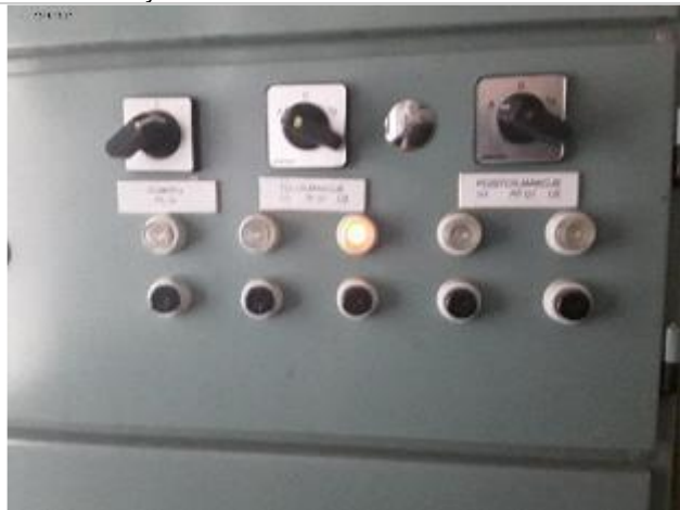
TK-01, LVI-keskus, joka on pääkeskuksen tavoin alkuperäistä perua
